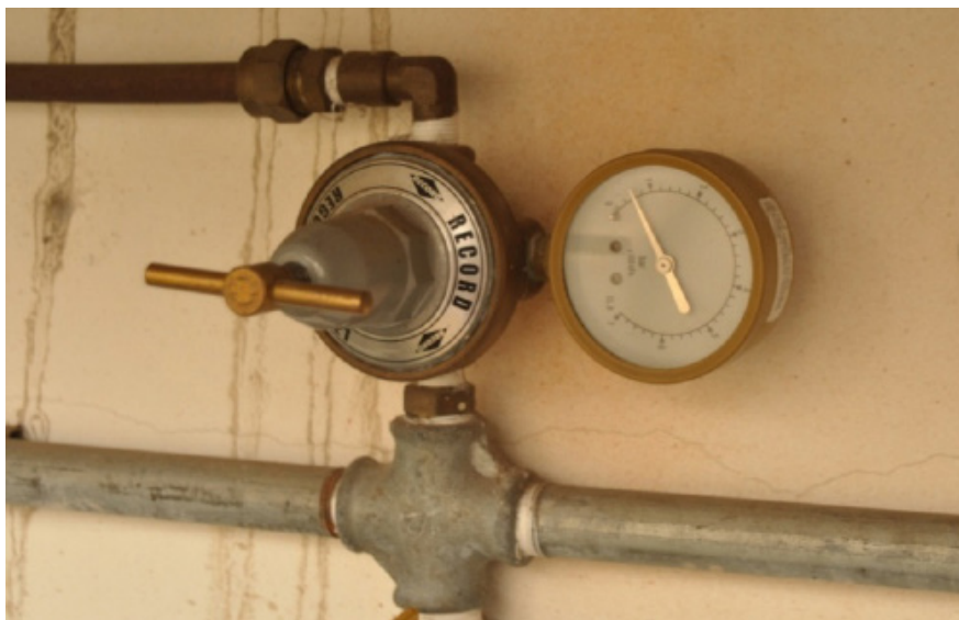
Figura 6 - Válvula para a liberação de gás dos cilindros para o forno, com a medição de pressão feita por um manômetro. É preciso que a pressão esteja regulada para começar a aquecer o forno.
