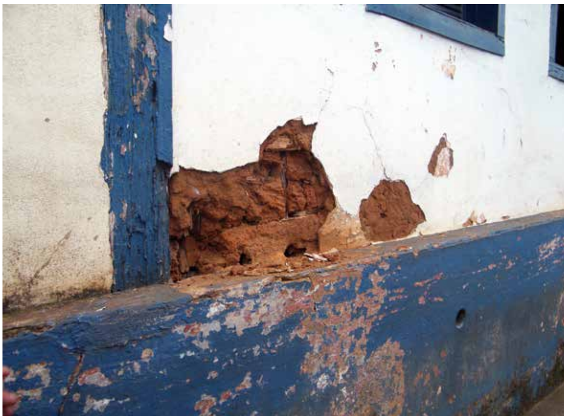
Deterioração de parede de pau-a-pique junto ao esteio
