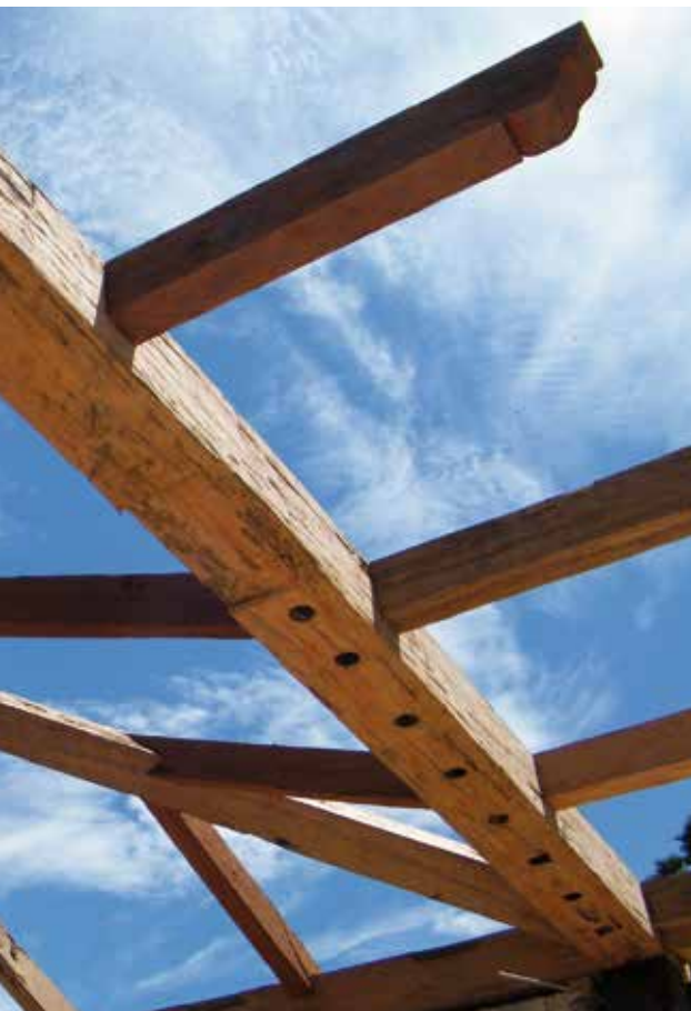
Vista interna de trecho do telhado em execução: encontro de várias águas do telhado
